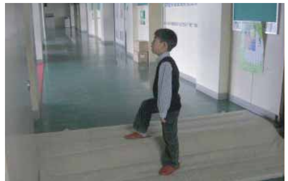
地震により西校舎と東校舎の段差が20センチ以上
