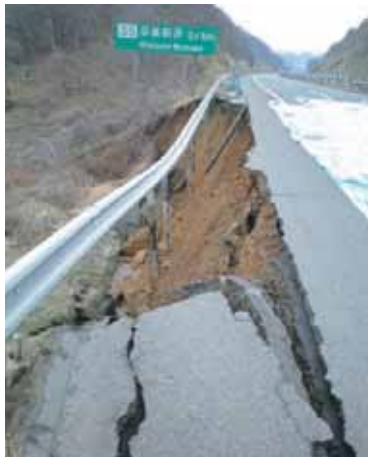
平泉前沢IC～水沢IC（上り線）の盛土変状
