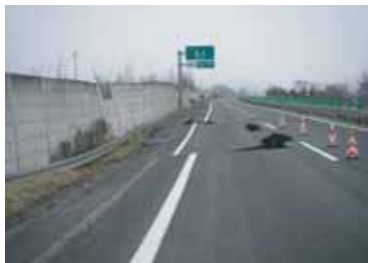
ひび割れが入った福島県の東北道国見IC付近
